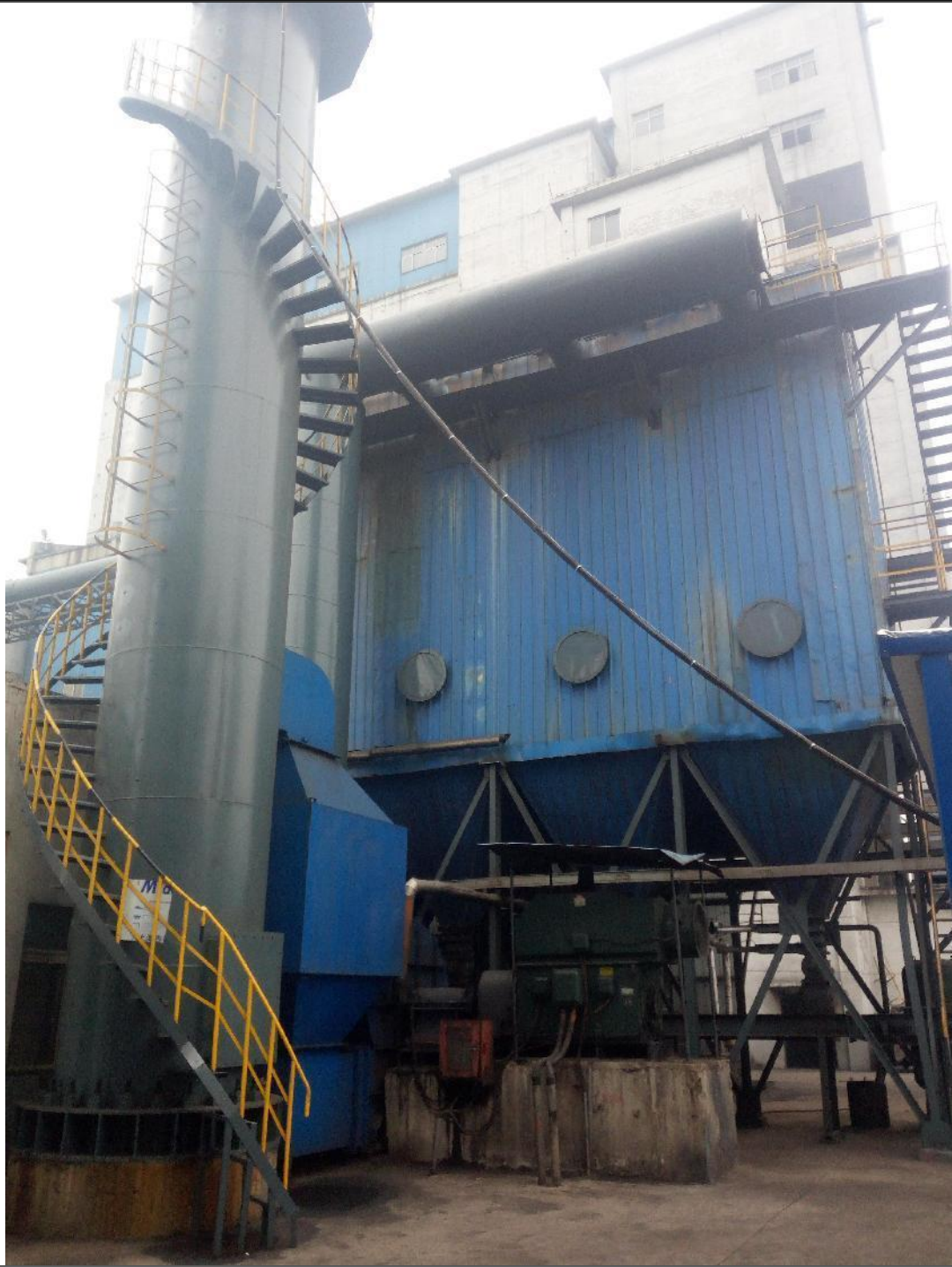
整改前炼焦一车间机侧地面除尘站
