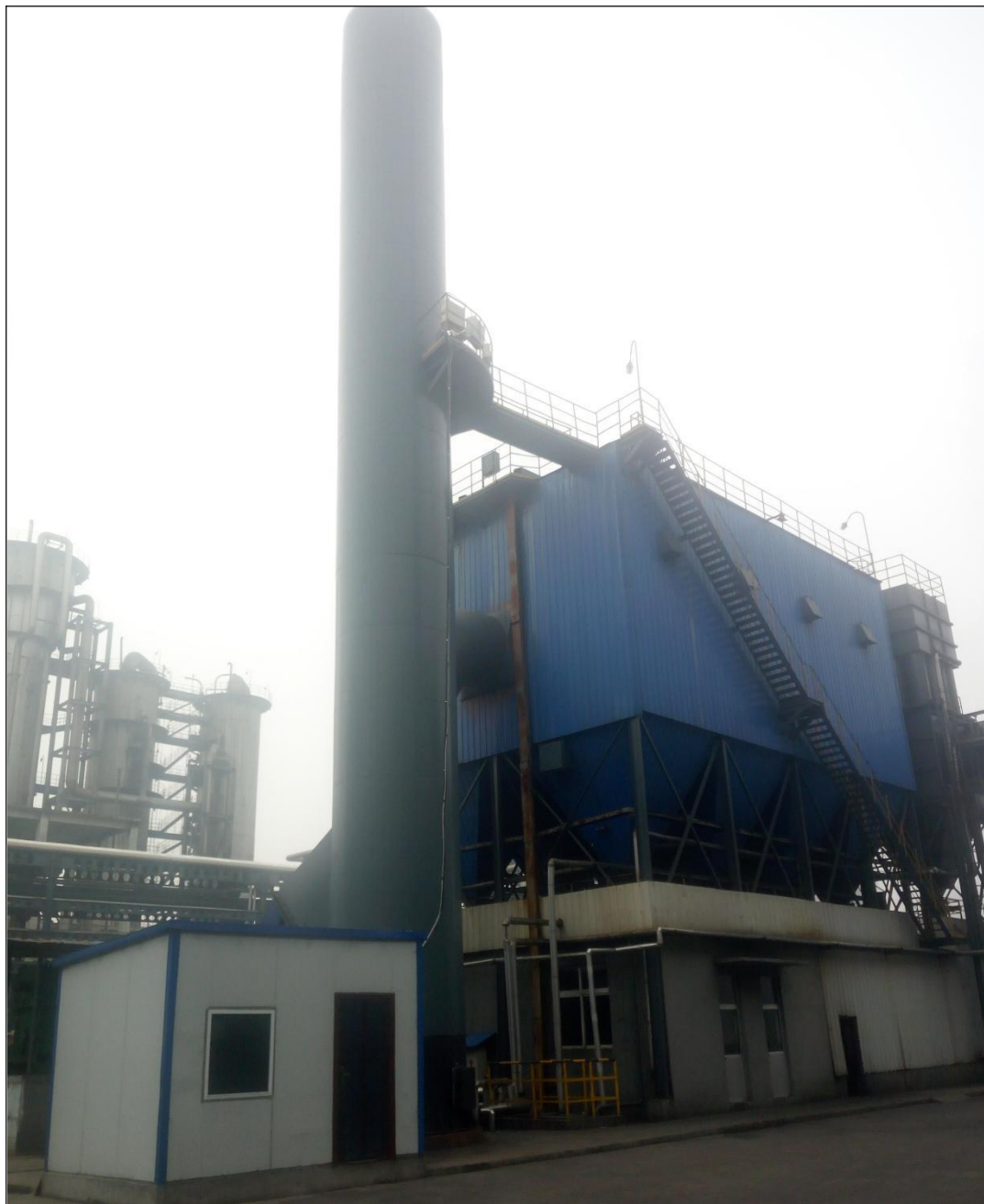
整改前炼焦一车间焦侧地面除尘站
